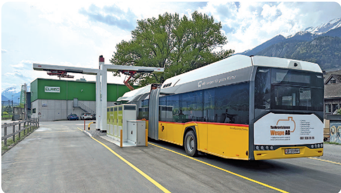
E-Ladestation für Postautos
